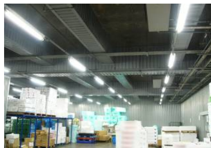
(物流倉庫導入例)
